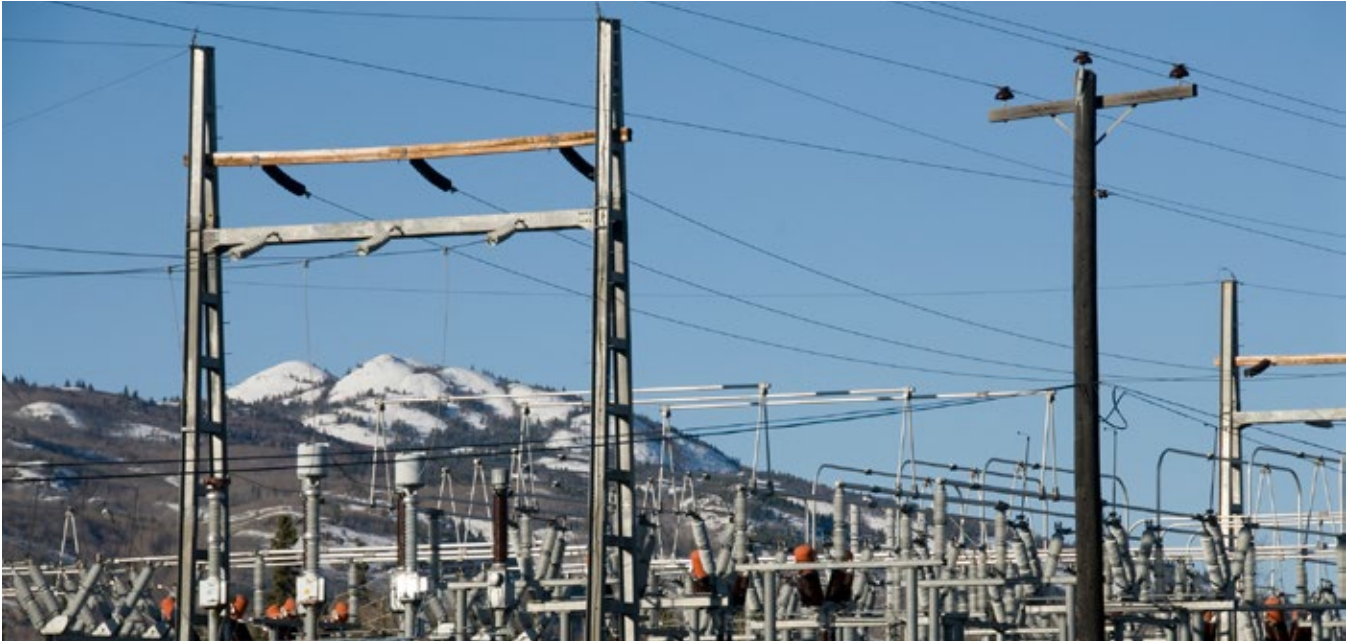
Poste de transformation.
