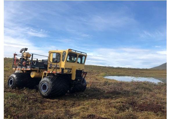
Un véhicule Rolligon est utilisé pour installer un conduit au milieu de la toundra. Grâce à ses gros pneus de type ballon, à basse pression, ce véhicule permet de réduire les perturbations à cet environnement fragile. La pression des pneus sur le sol est 15 fois inférieure à celle exercée par un pied humain.
