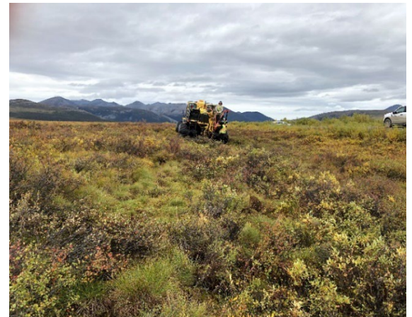
Résultat final de la pose du conduit au moyen du véhicule Rolligon.
