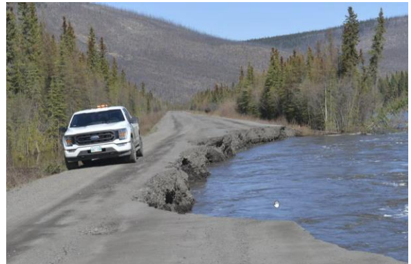
Route emportée par les eaux (mai 2023).
